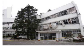
地震により倒壊した大規模建築物
