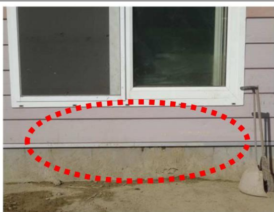
写真9：外壁に汚泥が侵入した形跡がみられる。
