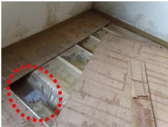
写真5: 床上への浸水により、床下地と防湿フィルムの間に水がたまっている。
