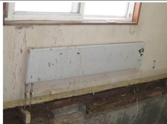
写真8: 壁に設置されたパネルラジエーターの温水管に浸水の形跡がある。
