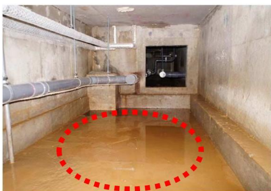
写真1：床下に汚泥と水がたまっており、床下空間が湿潤状態となっている。
