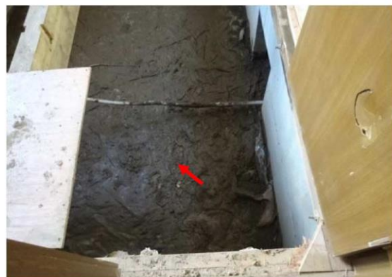
写真2：床下への浸水により、汚泥が流入し堆積している。
