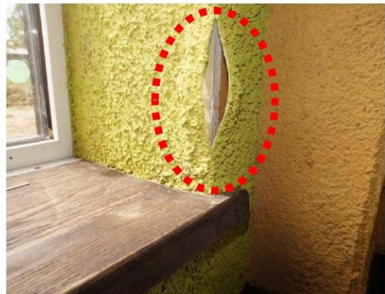
写真10：内装仕上げ及び下地材が水分を含み、膨張・剥離している。
