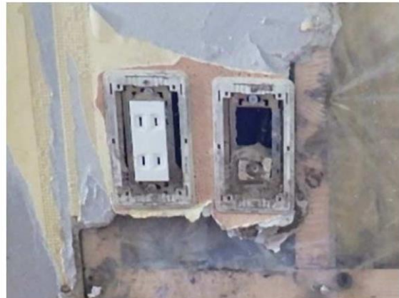
写真12：壁に設置されたコンセントボックス内に汚泥が残っている。
