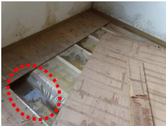
写真5: 床上への浸水により、床下地と防湿フィルムの間に水がたまっている。
