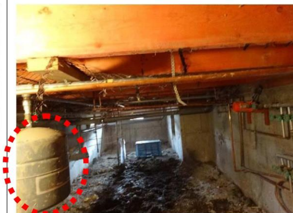
写真4：床下の設備機器に浸水した形跡がある。
