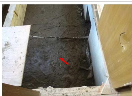
写真2：床下への浸水により、汚泥が流入し堆積している。
