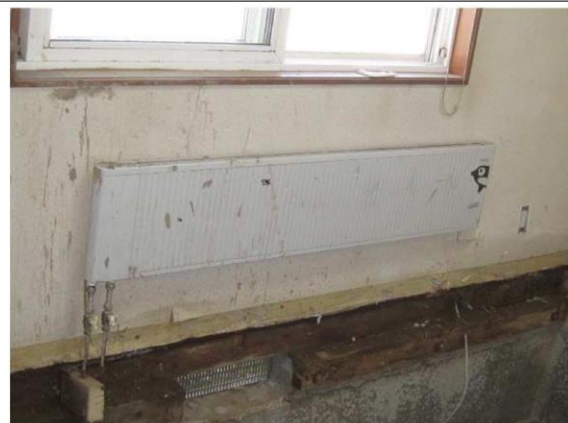
写真8: 壁に設置されたパネルラジエーターの温水配管に浸水の形跡がある。
