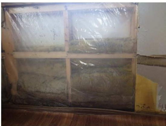
写真11：壁内部の断熱材が吸水し、脱落している。
