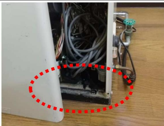
写真7: 床に設置した設備が浸水し、内部に汚泥が侵入した形跡がみられる。
