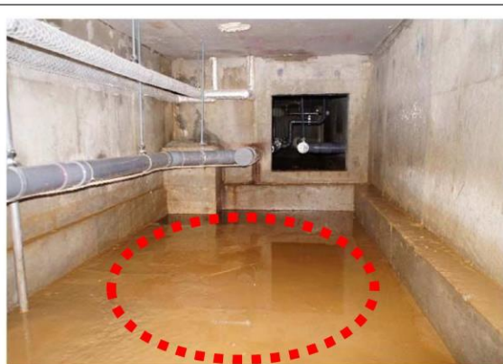
写真1：床下に汚泥と水がたまっており、床下空間が湿潤状態となっている。
