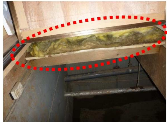
写真6: 床上への浸水により、床の断熱材が水と汚泥により汚損している。
