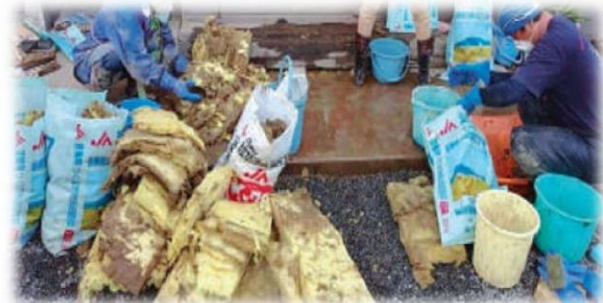
浸水したグラスウール
